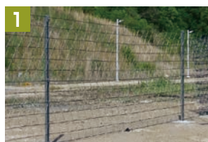
通常設置状態
